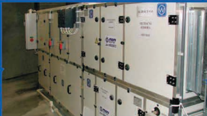
Отель «Регмон» Вентиляционные установки для бассейнов серии H/HL, (5 установок) общей мощности прил. 45.000 м3/час
