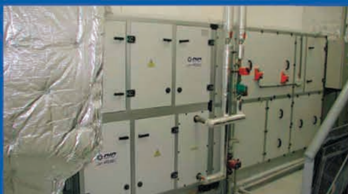
Жилой комплекс На Гржебенках Вентиляционная установка для бассейнов H/HL, общей мощности 5.600 м3/час
