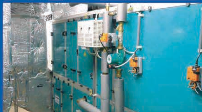
Санаторий в г. Киев, Франтишковы Лазне Вентиляционные установки для бассейнов H/HL, (2 установки) общей мощности 7.700 м3/час.
