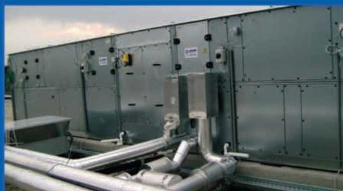
Voest Alpine Krems, Австрия Вентиляционная установка серии H/NL общей мощности 5.000 м³/час.
