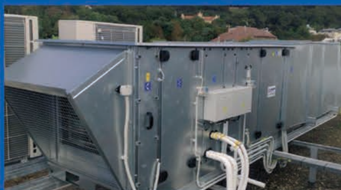
KFC Новы Смихов Вентиляционные установки серии H/NL (2 установки) общей мощности 20.000 м³/час
